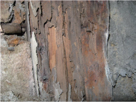
＜写真 3 木部の劣化が激しい＞
