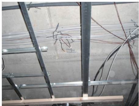
<写真8 天井裏に設置した熱電対>
