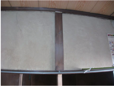
＜写真 4 柱と梁の間に隙間がある＞
